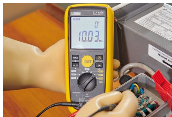
Vorbeugende Wartung an einem Motor
